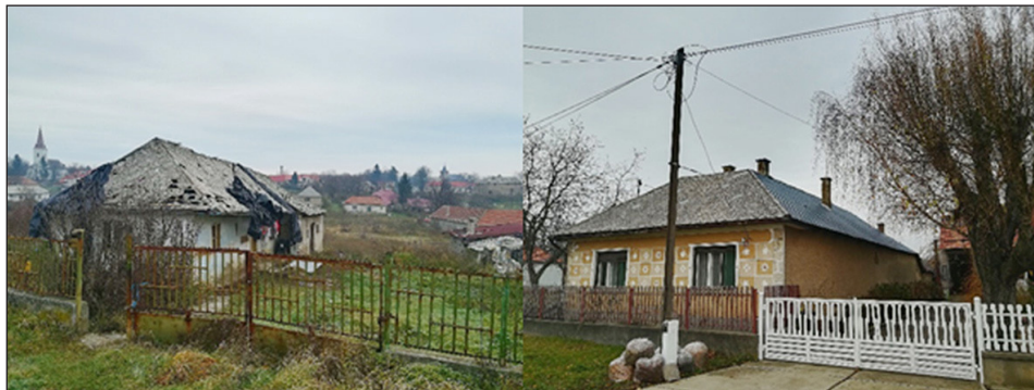
1. ábra. Egy, a katasztrófaeseményt követően elhagyottá vált ház Megyaszón (bal) ; kényszerűségből vegyes anyagokkal javított tetőzetű lakóház Megyaszón (jobb) Forrás: Saját felvétel
